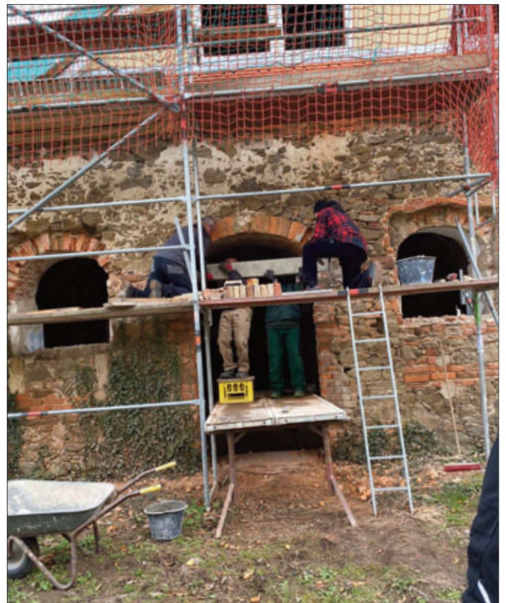
Setzen Sturz Eingang zum Restaurant
