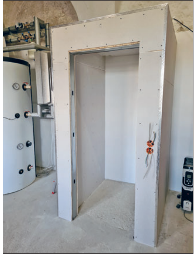
Raum für die Brandmeldeanlage
