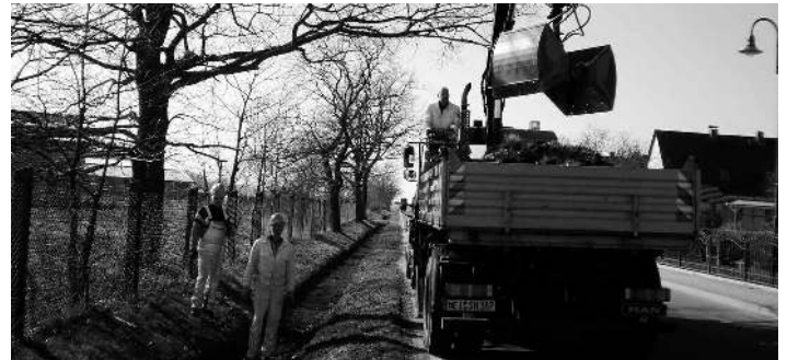
Unterhaltung der Versickerungsmulde entlang der Kreisstraße in der Ortslage Streumen durch die Kreisstraßenmeisterei.
