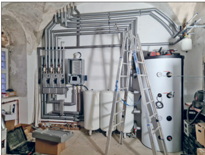
Heizanlage im Haus 2
